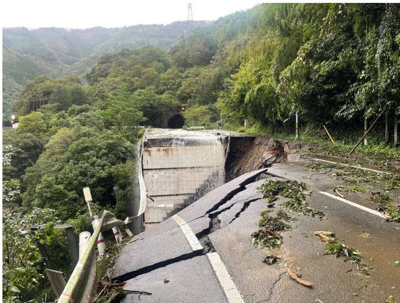
令和4年9月 台風14号による道路路肩損壊【宮崎県諸塚村】 出典：国土交通省
